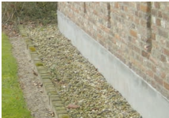
Opvang van hemelwater in grindsleuf direct naast woning
