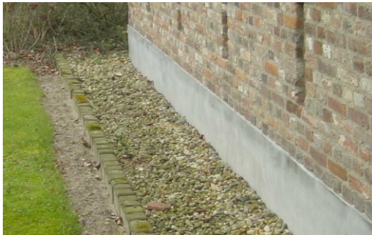
Opvang van hemelwater in grindsleuf direct naast woning
